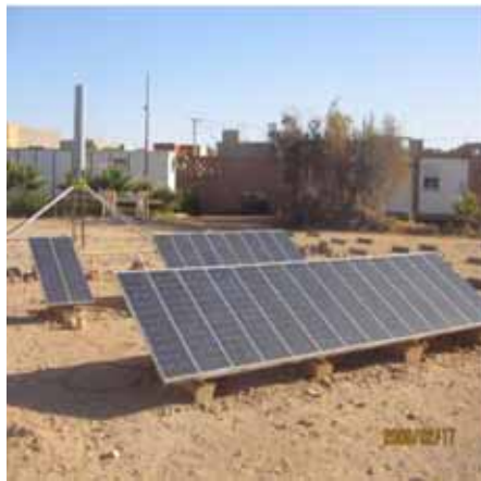
Fig. 5: Vue générale d'un générateur photovoltaïque
