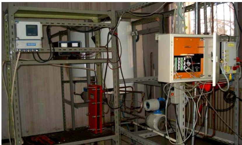
Fig. 6: Vue de l'installation comportant le circuit hydraulique, la chaîne d'acquisition de données, l'échangeur à plaques et les différents instruments de mesures
