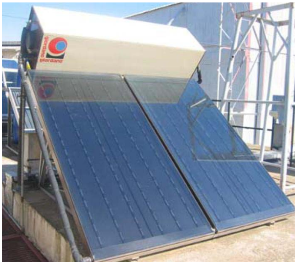
Fig. 1: Installation expérimentale (chauffe eau ) à Bouzaréah, Alger
