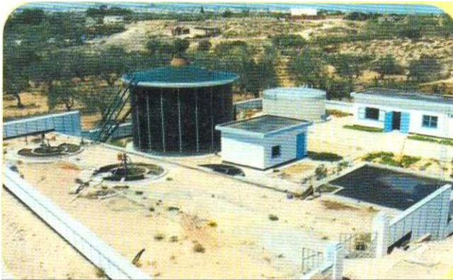
Fig.1: Vue générale de l'installation intégrale de bio méthanisation industrielle adoptée
